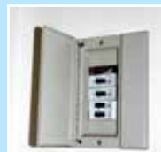
Disjuntor da residência
