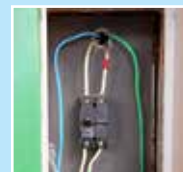
Disjuntor da medição
